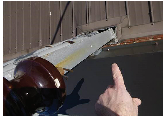
Ouverture autour du mât électrique (infiltration d'eau possible)
