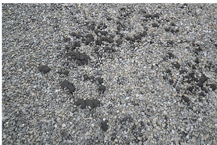
Bulles d'asphalte en surface
