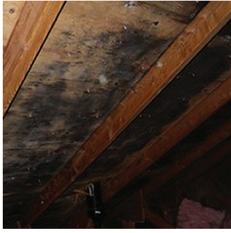
Cernes d'humidité dans un entretoit
