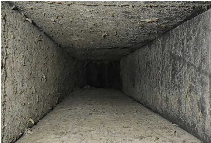
Conduit de ventilation ayant besoin d'entretien
