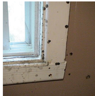
Cadrage de fenêtre avec moisissures
