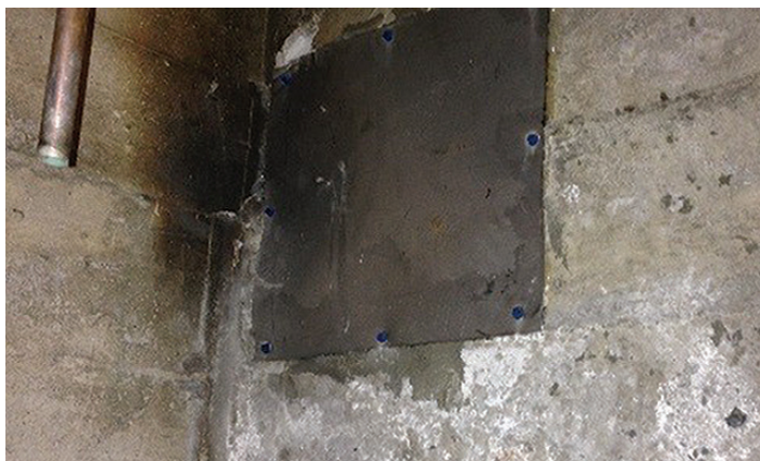
Efflorescence et cernes d'humidité dans un sous-sol
