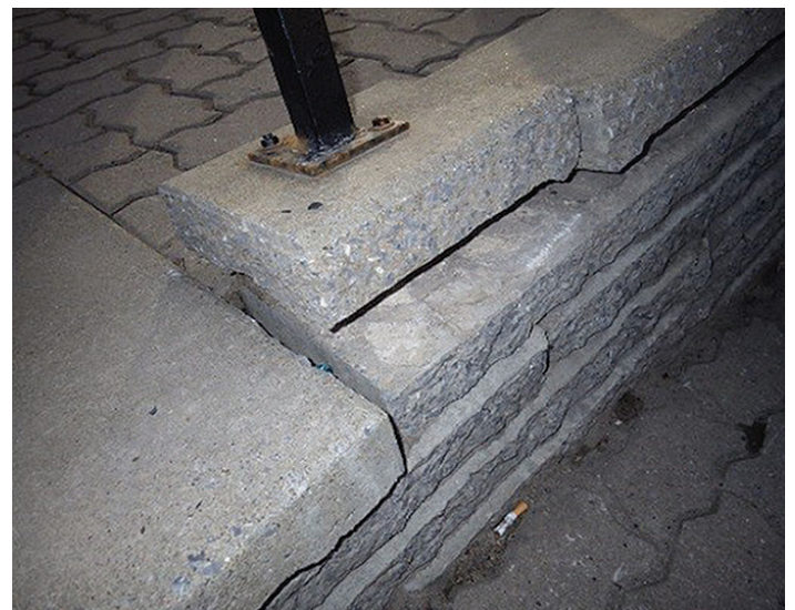
Garde-corps mal fixé au sol
