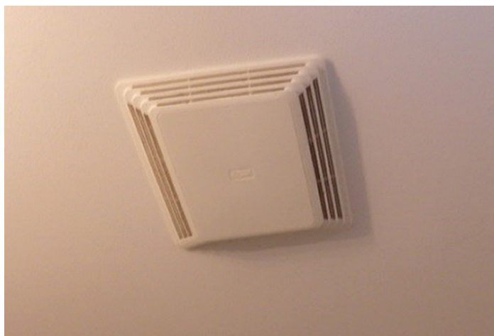
Un ventilateur de salle de bain fonctionnel aide à réduire l'humidité excessive et la présence de moisissure
