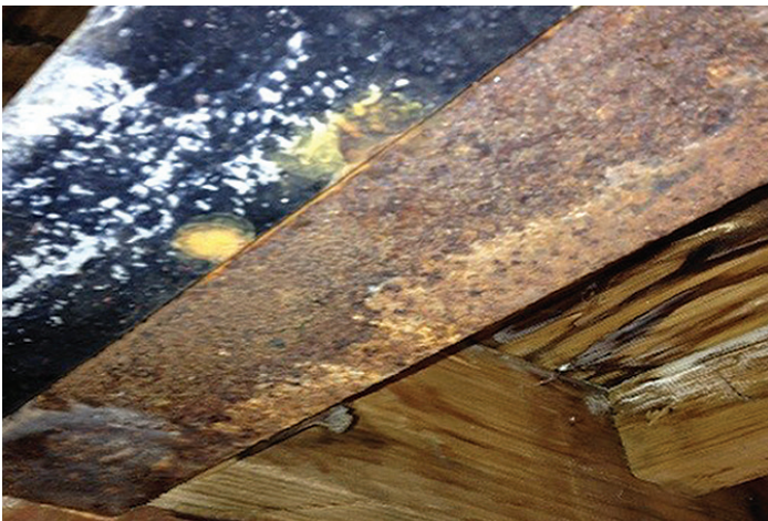
Structure d'acier endommagée sous un balcon
