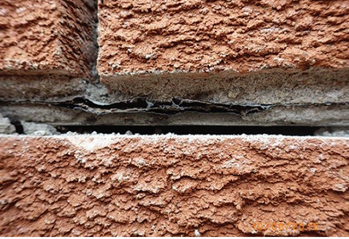
Mortier désagrégé/manque de mortier
