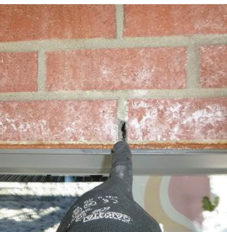
Chantepleure partiellement obstruée
