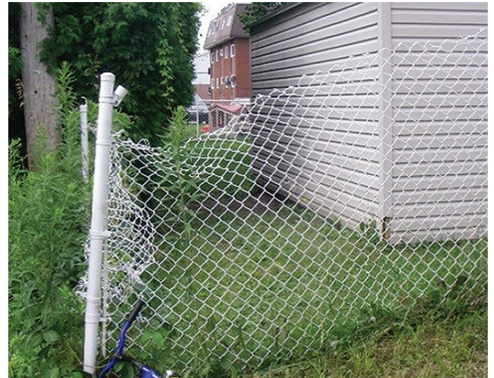
Clôture ayant subi un bris
