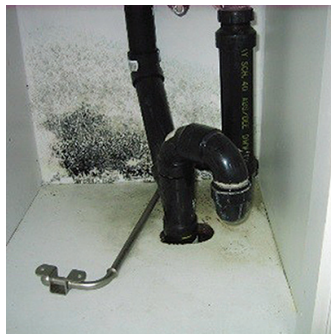
Dessous d'évier avec moisissures
