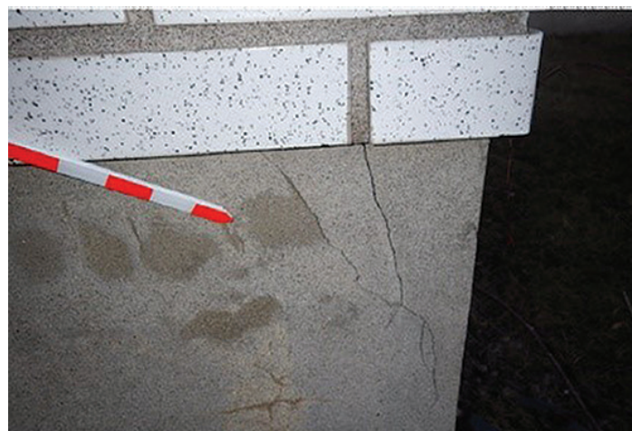
Petite fissure de crépis
