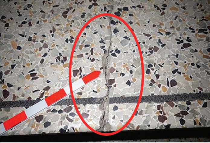
Fissure dans une marche
