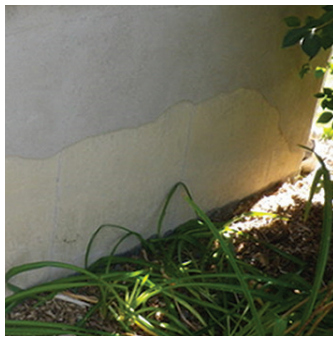
Dégradation du crépi
