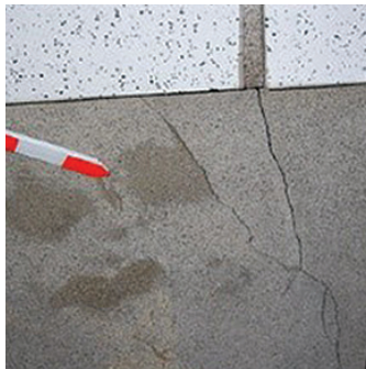
Petite fissure de crépis
