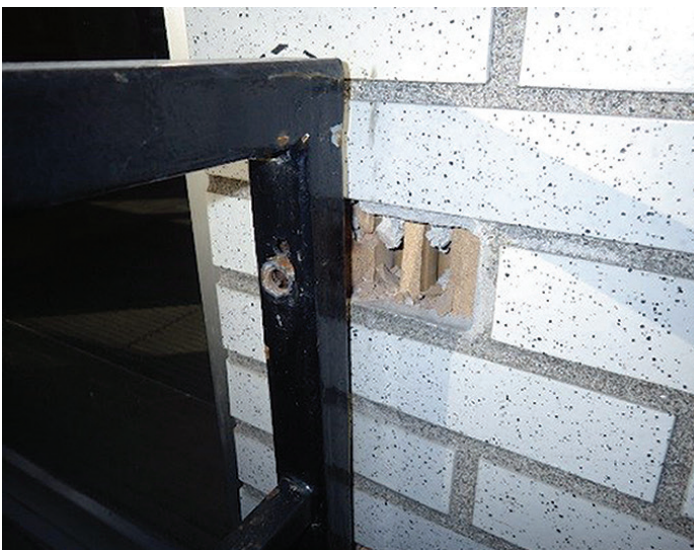
Garde-corps mal fixé au mur extérieur
