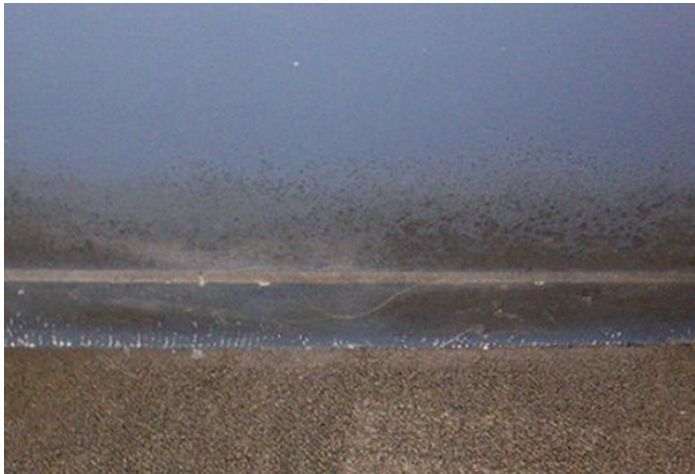
Moisissures dans le bas d'un mur
