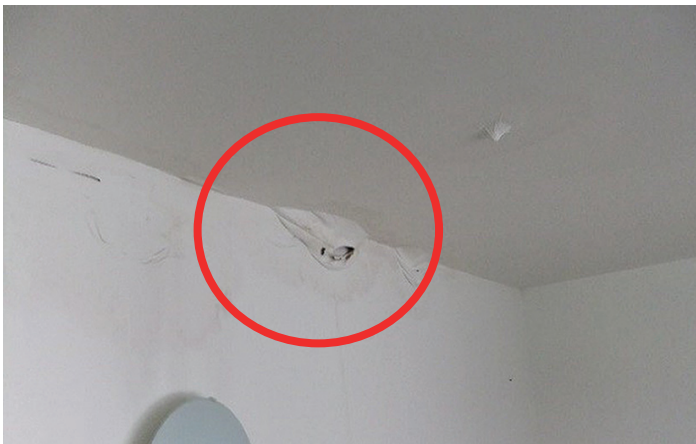
Infiltration d'eau sous la peinture
