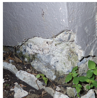
Dégradation d'un coin de fondation
