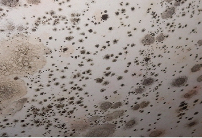
Plafond recouvert de moisissures
