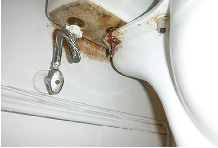
Fuite d'eau sous le réservoir d'une toilette
