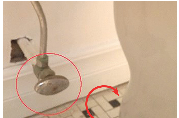
Valve de la toilette
