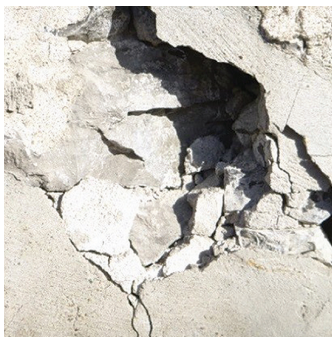
Dégradation importante du mortier sur un mur en pierre
