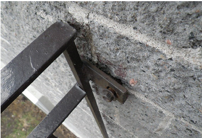
Garde-corps mal fixé
