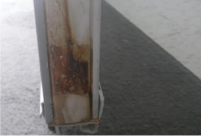
Traces d'humidité sur une porte
