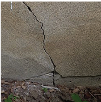
Fissure dans la fondation
