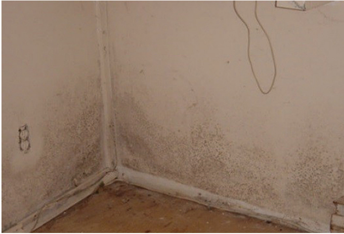
Mur couvert de moisissures
