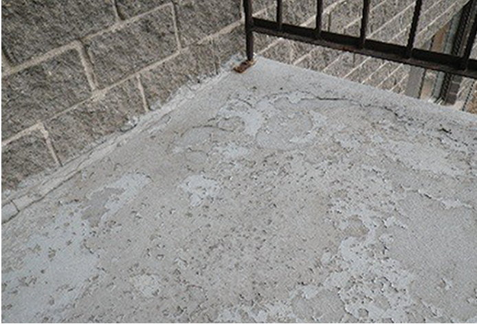
Revêtement de balcon endommagé
