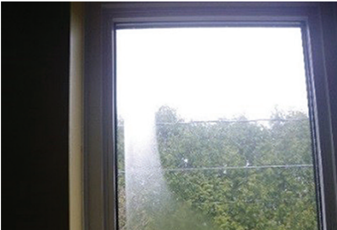
Buée entre les thermos d'une fenêtre
