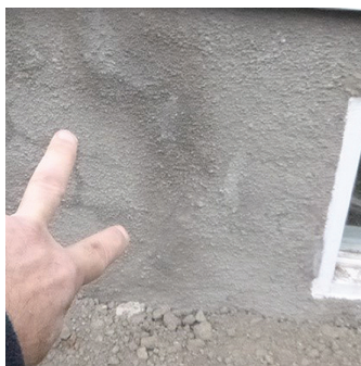
Cernes d'humidité sur une fondation
